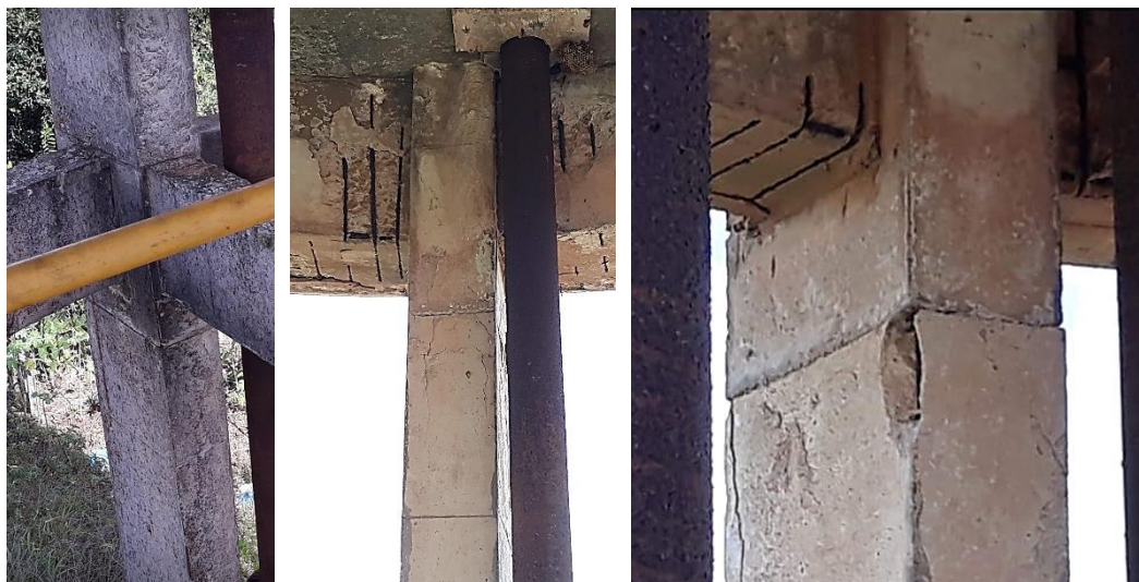
Figura 43 – Trincas e pequenos deslocamentos nos pilares do reservatório A.
